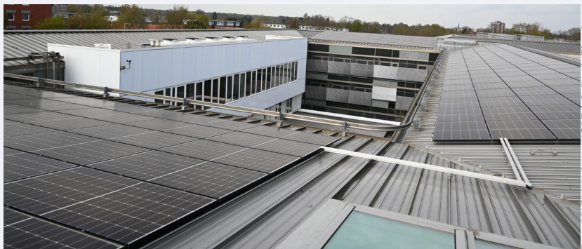
Foto 12: PV-Anlage KGSE | © Stadt Elmshorn
