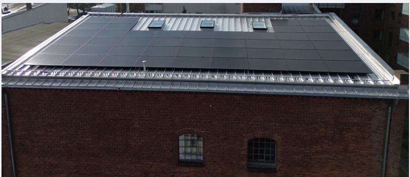
Foto 9: PV-Anlage IM | © Stadt Elmshorn
