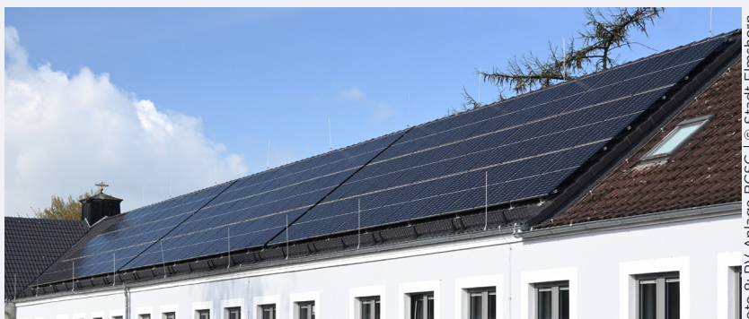
Foto 8: PV-Anlage BCSG | © Stadt Elmshorn
